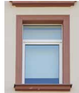
Bild 4: Keine altbaugerechte Fensterteilung
